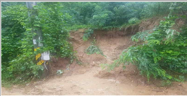
상하동 공사장 토사유출 피해
