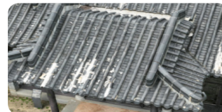
공원시설 노후화 점검
