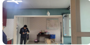
노인회관 벽체 균열 안전점검
