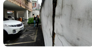
담장 파손 안전점검
