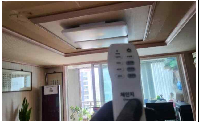
리모컨형 조명 설치
