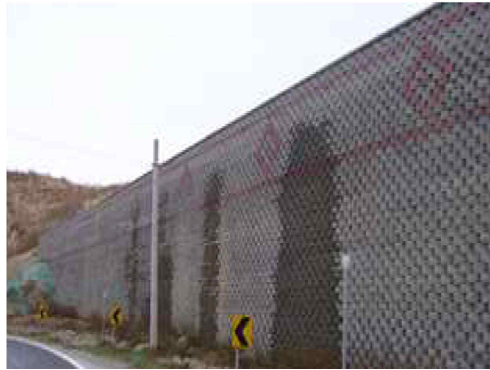
전면 상단부 누수 흔적 예시
