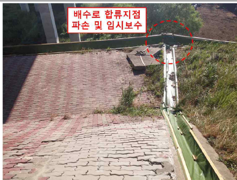
배수로 파손 예시
