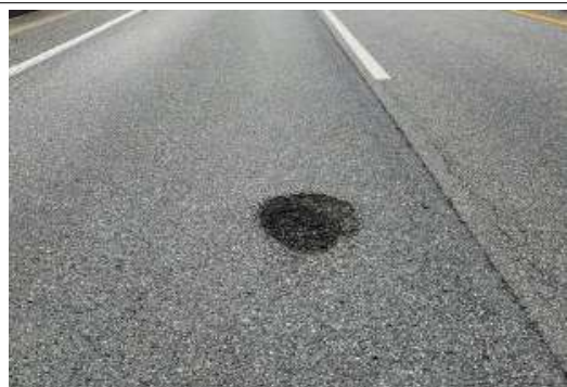
상부 포장체 파손(포트홀) 예시
