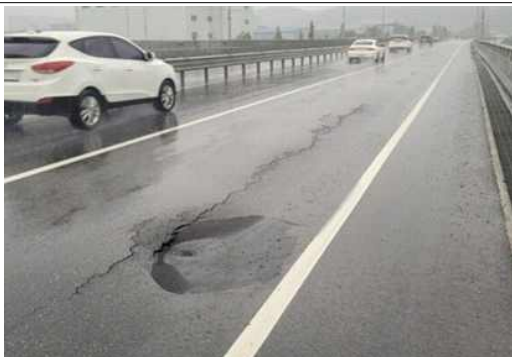
상부 도로 침하 예시
