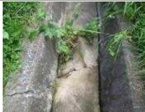
배수로 균열 예시(우수 유입 가능)
